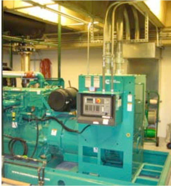
Instalación Permanente Típica de un Generador
